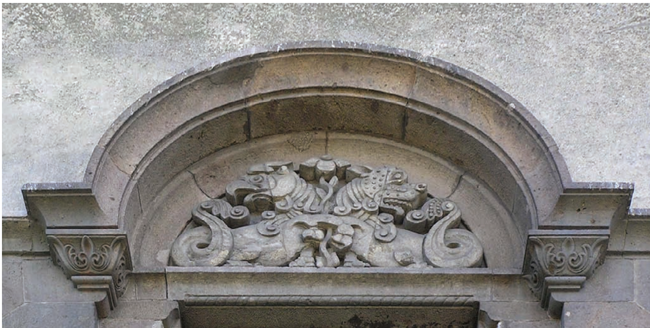
6. Тимпанон изнад средишњег прозора на првом спрату 6. Tympanum above the central window on the first floor
